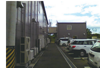
室外機が22台ある通路
