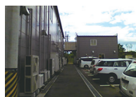
室外機が22台ある通路
