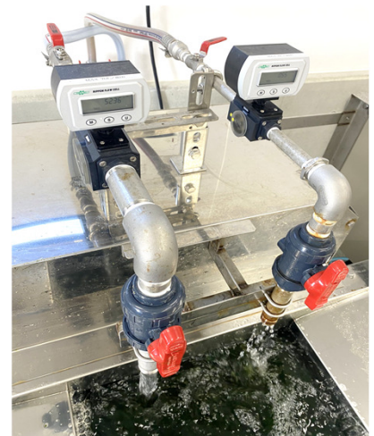
洗浄水塩分コントロール
