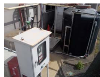
【排水処理設備】
